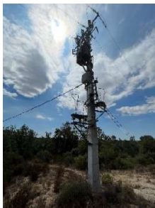
CENTRE DE TRANSFORMACIÓ CENTRO DE TRANSFORMACIÓN
